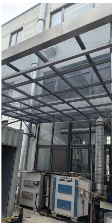
图 4.1-1 注塑废气处理装置 TA001 及排气筒 DA001
