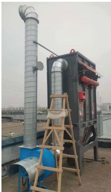
图 4.1-2 破碎废气处理装置 TA002 及排气筒 DA002（位于楼顶）
